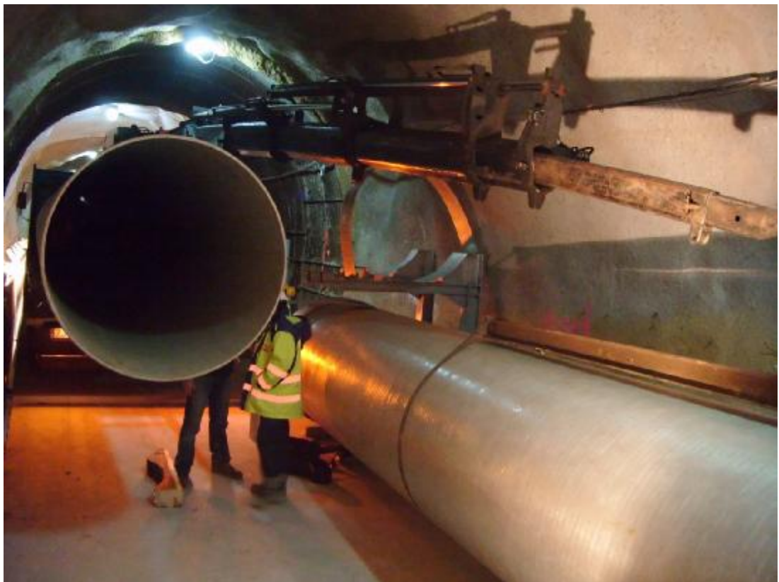
Tubería de PRFV
