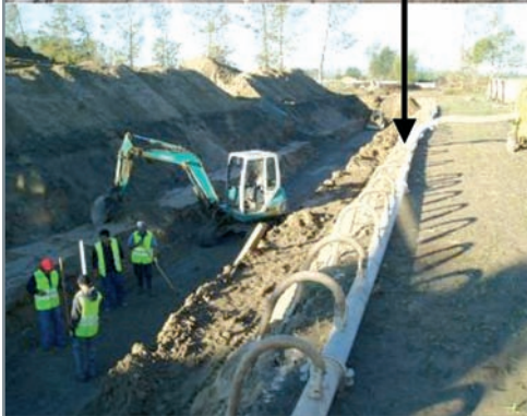
Colector que conduce el agua freática hasta cauce, acequia o balsa decantación
